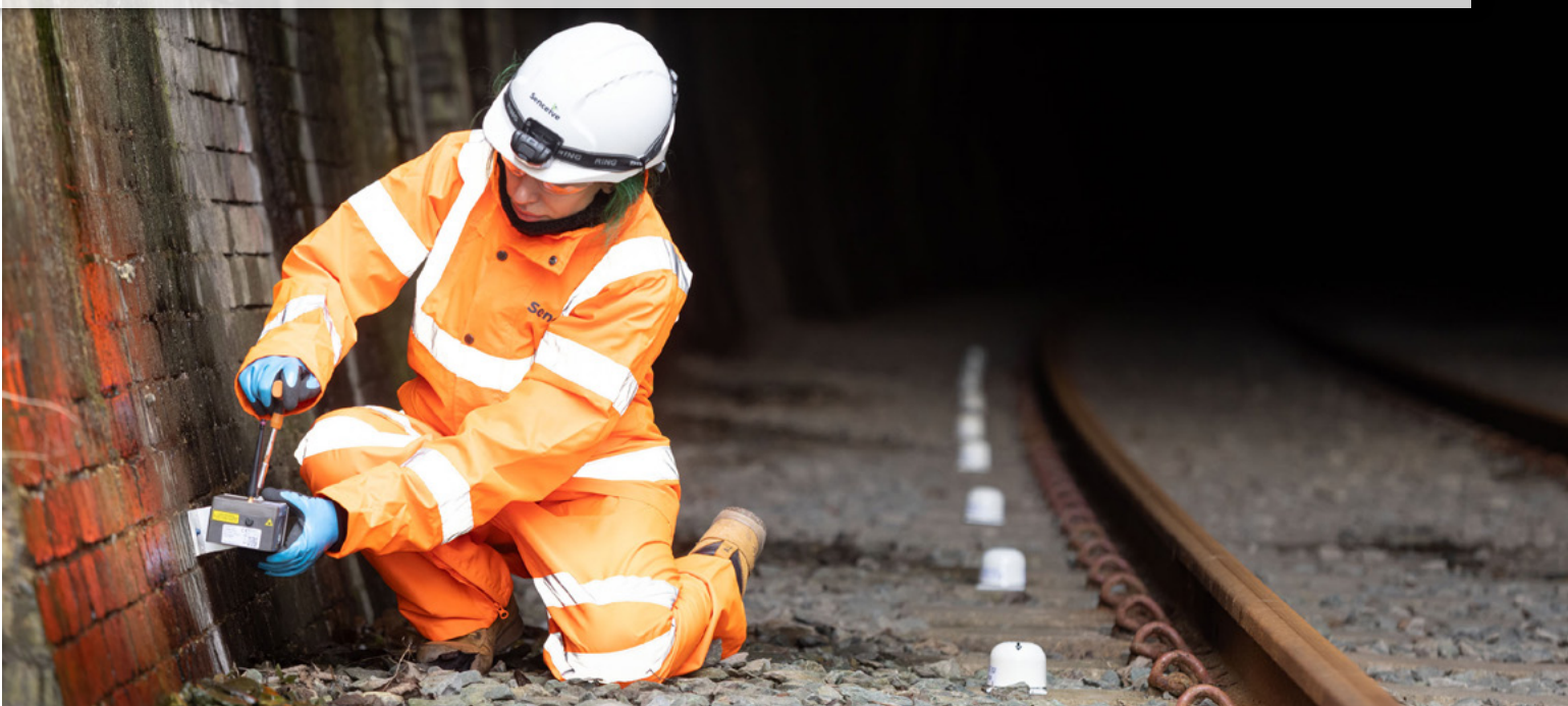
Capteurs pour la surveillance des tunnels
