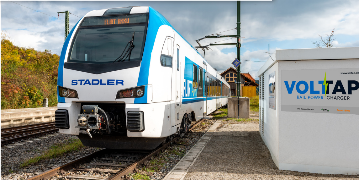
La station de recharge rapide VOLTAP se compose d'un poste de transformation (au premier plan) et d'une caténaire avec des mâts de charge et un rail de charge. Photo : swt/Marquardt
