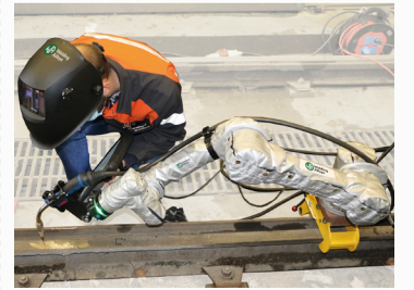
Démonstration sur les rails d'un client
